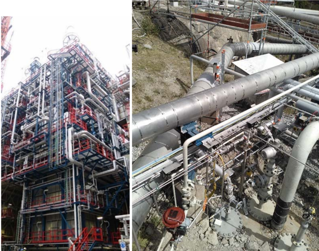
Figur Den renoverade D-ugnen till vänster och utrustning kopplat till bergrummet UC-902 för buffertkapacitet och mellanlagring av förorenat processvatten.
