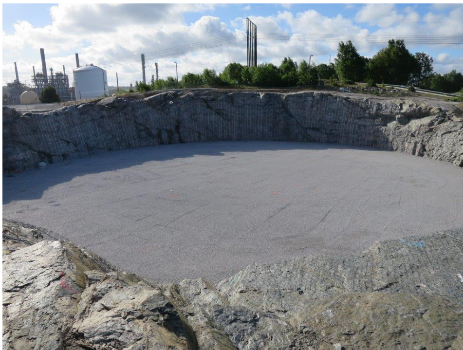
Markförberedelser har påbörjats för att bygga en ny, specialbyggd tank för lagring av kyld etan vid Borealis anläggningar i Stenungsund. © Borealis
